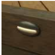
Éclairage de contremarche
