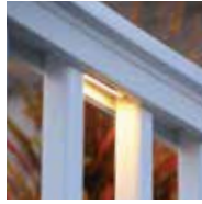
Éclairage sous le garde-corps
